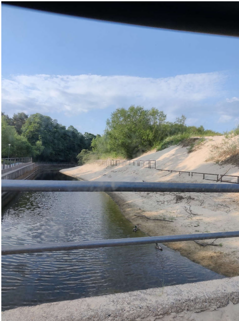
3.3.3 pav. Pietinės Rąžės upelio dalies užnešimas smėliu
